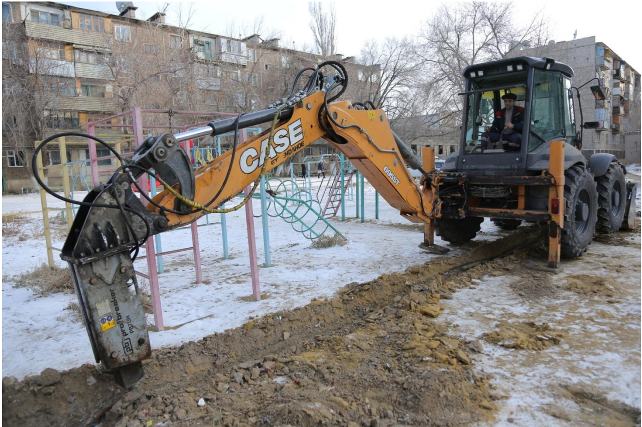
Водопроводные сети ул. Момышулы 22
