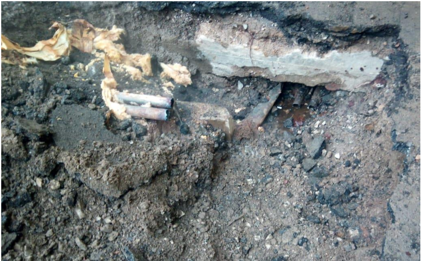
Тепловые сети по ул.Сатпаева 32
